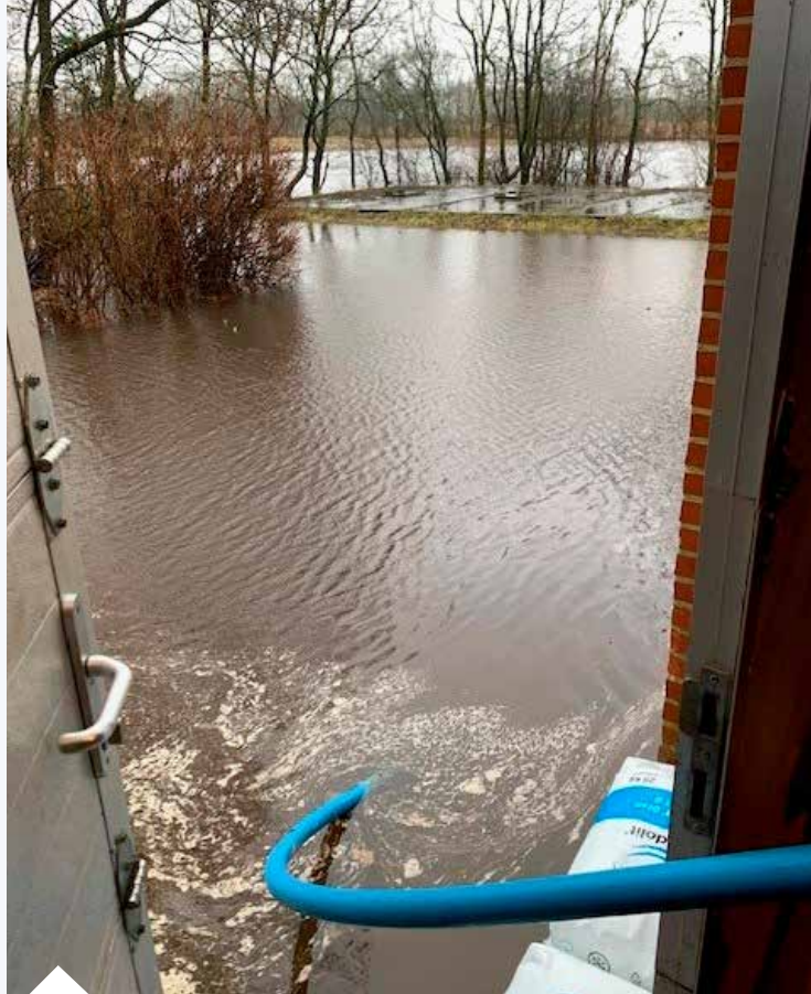
I gang med at pumpe vand væk fra vandværket. Bemærk sække med filtergrus, der er lagt ud for at forhindre, at vandet trænger ind i bygningen.
